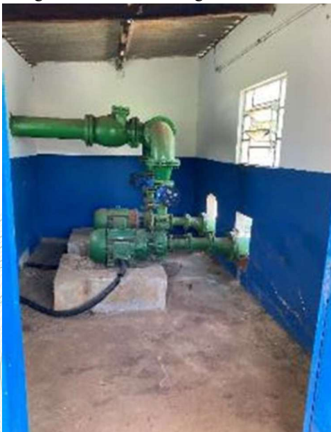
Figura 66- Recalque de água bruta para ETA 2
