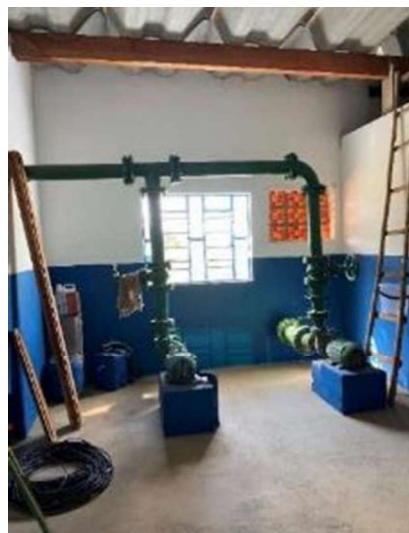
Figura 74 - Recalque para a ETA 3
