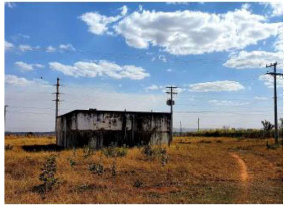
Figura 88 Reservatório Apoiado Lar Esperança (Caixa Quadrada).
