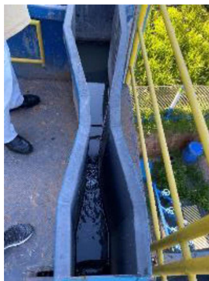
Figura 105 - Calha Parshall – entrada dos esgotos
