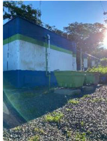
Figura 109 - Caçambas para recolhimento do lodo
