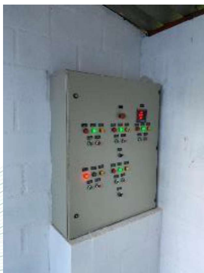
Figura 104 – Quadro de comando da ETE
