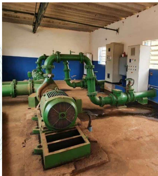
Figura 22 - Estação de recalque para a ETA 1 - Nazaré.
