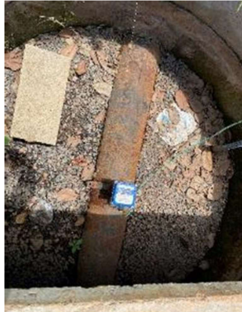
Figura 67- Medidor eletromagnético para água bruta
