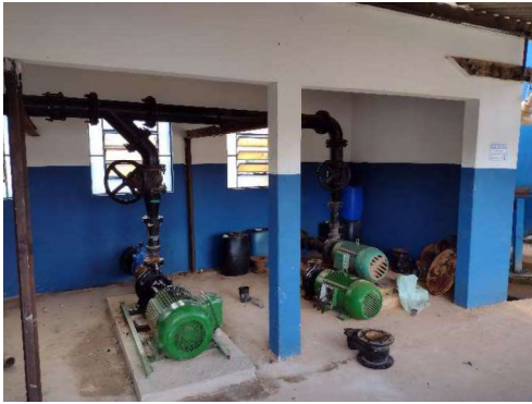
Figura 70- Estação de recalque de água tratada.
