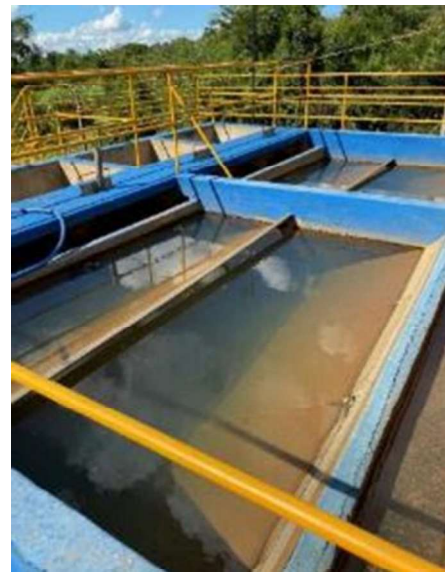
Figura 78 - Decantadores e filtros ao fundo
