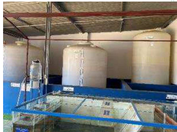
Figura 61 - Armazenamento de produtos químicos instalados em bacias de contenção
