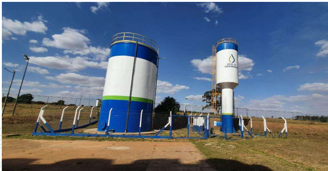
Figura 93 - Reservatórios do CAIC
