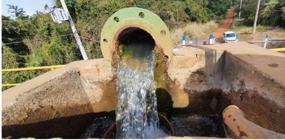
Figura 75 - Entrada de água bruta
