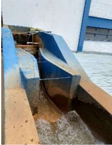
Figura 52 - Entrada de água bruta, calha Parshall, adição de produtos químicos.
