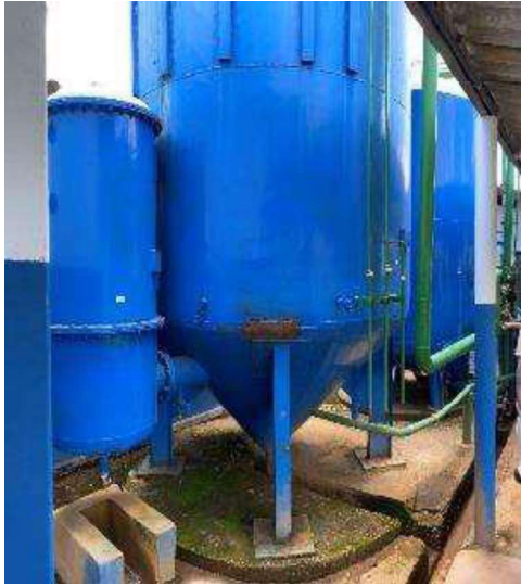
Figura 68- Floculador e decantador da ETA 2
