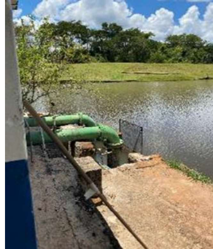
Figura 27 - Conjunto motobomba ETA 3
