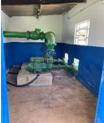
Figura 26 - Conjunto motobomba ETA 3
